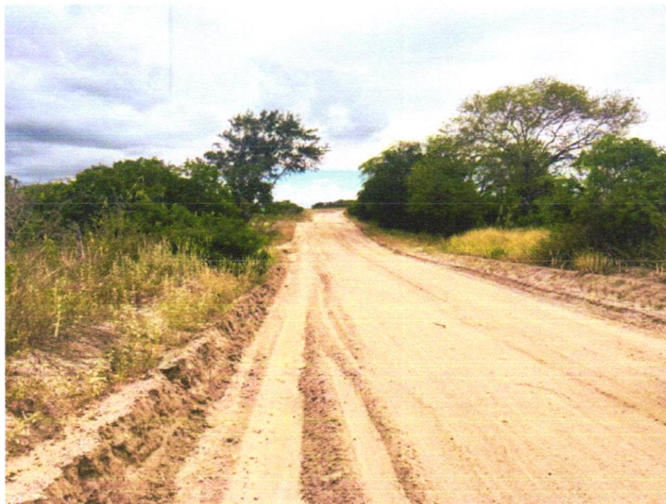
Foto 11 – EXECUÇÃO E COMPACTAÇÃO DE ATERRO COM SOLO PREDOMINANTEMENTE ARGILOSO - EXCLUSIVE SOLO, ESCAVAÇÃO, CARGA E TRANSPORTE. AF_11/2019
