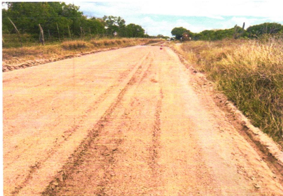
Foto 14 - EXECUÇÃO E COMPACTAÇÃO DE ATERRO COM SOLO PREDOMINANTEMENTE ARGILOSO - EXCLUSIVE SOLO, ESCAVAÇÃO, CARGA E TRANSPORTE. AF_11/2019
